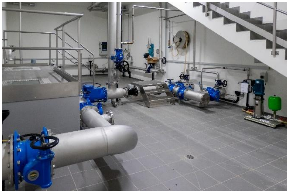
Abb. 16: RES Blattweid Installationen UG
