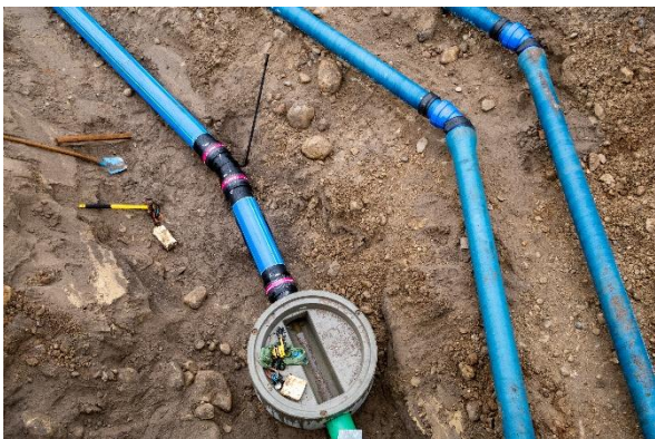
Abb. 18: Leitungsbauten vor dem RES Blattweid
