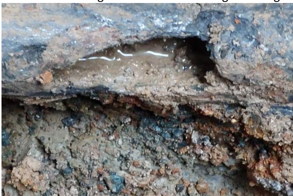
Abb. 24: Leck in Wasserleitung
