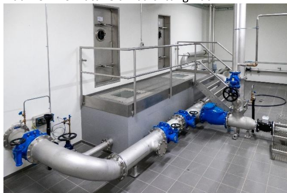
Abb. 15: RES Blattweid Installationen UG
