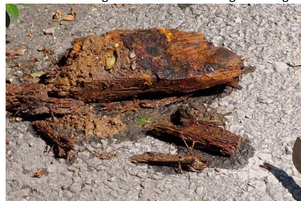
Abb. 25: Holzunterlage als Ursache Leck in Leitung
